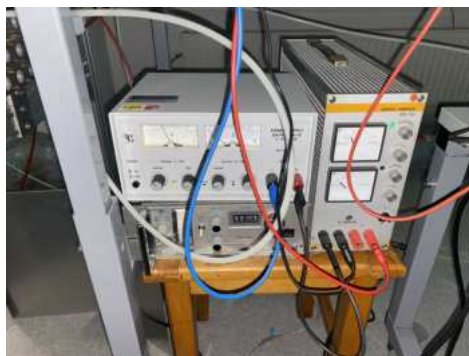
Abbildung 3.4: Bild des Hochspannungsversorgung für die Driftröhre und der Verstärkerschaltung.
