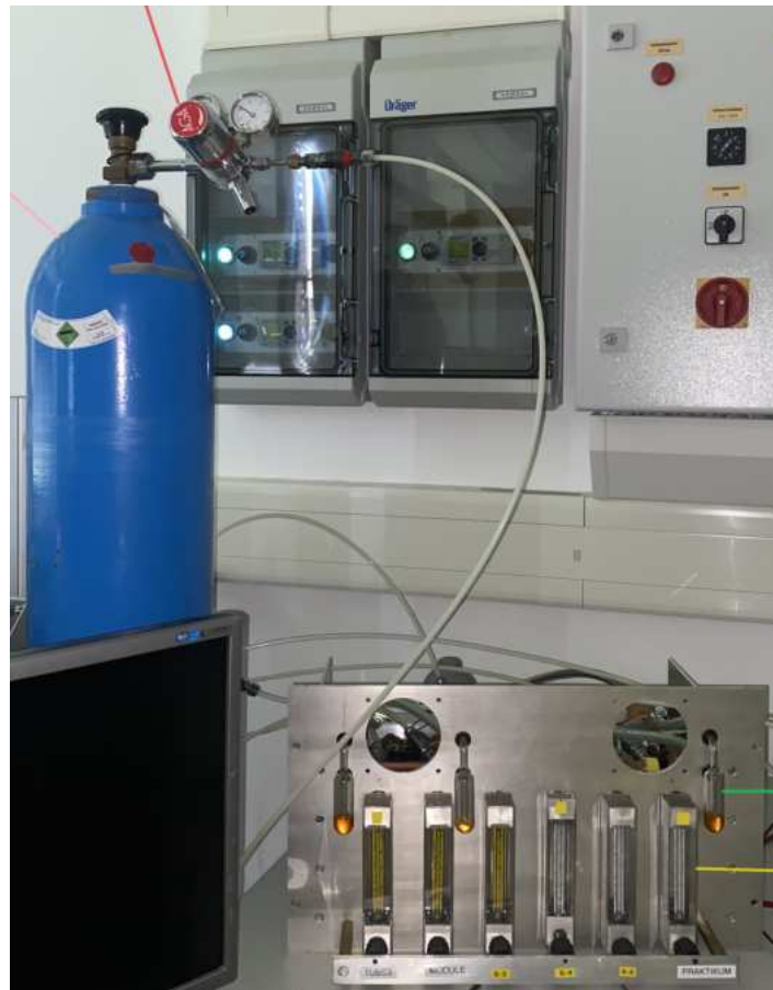
Abbildung 3.10: Bild des Aufbaus der Gasversorgung.
